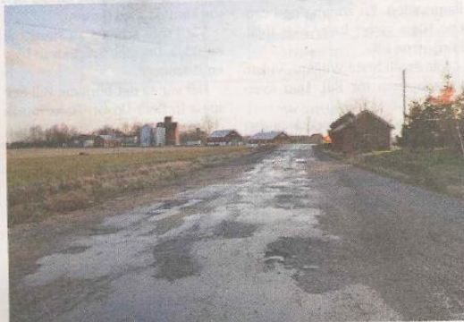
Väg 575 mellan Arboga och Himmeta består av håligheter och bulor och är en av de sämre vägarna i området öst om NCC sköter.
